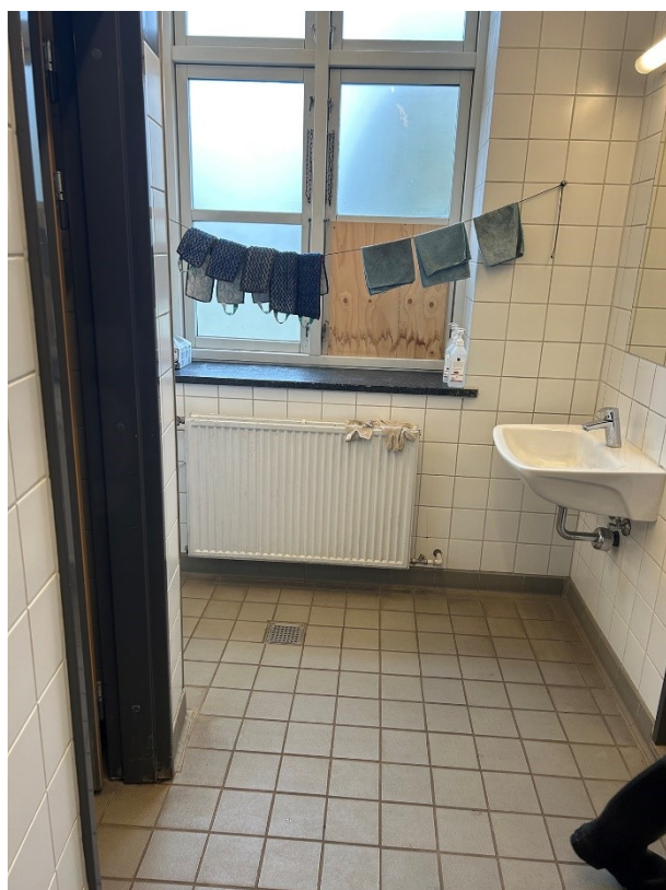
Toiletforhold på Garderkasernen i Høvelte.
