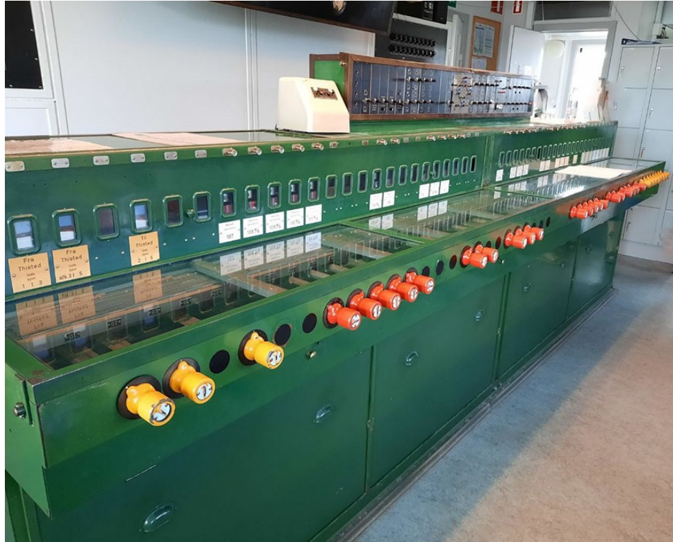
Ældre sikringsanlæg på Struer Station. Anlægget er taget ud af drift i februar 2021.
